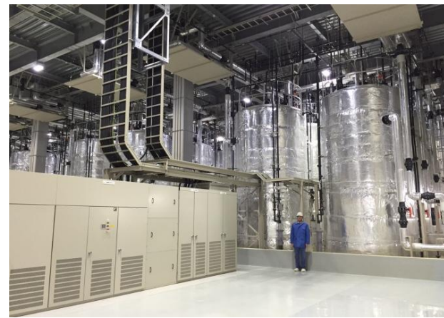
<建屋内の交直変換装置・電解液タンク>
