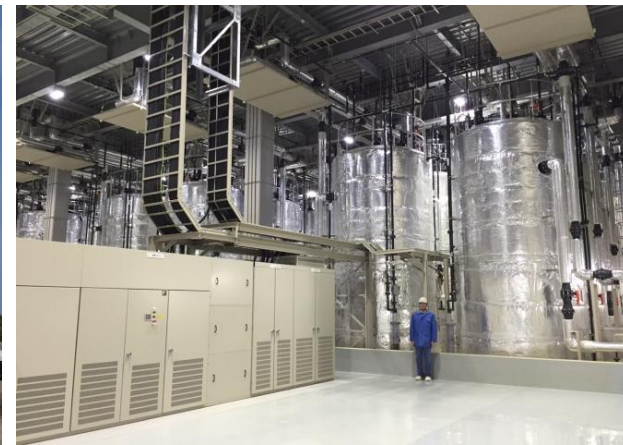
<建屋内の電解液タンク>
