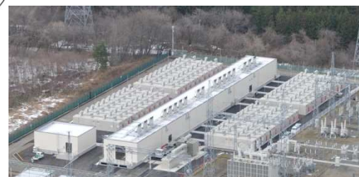
図2 蓄電池システム外観
