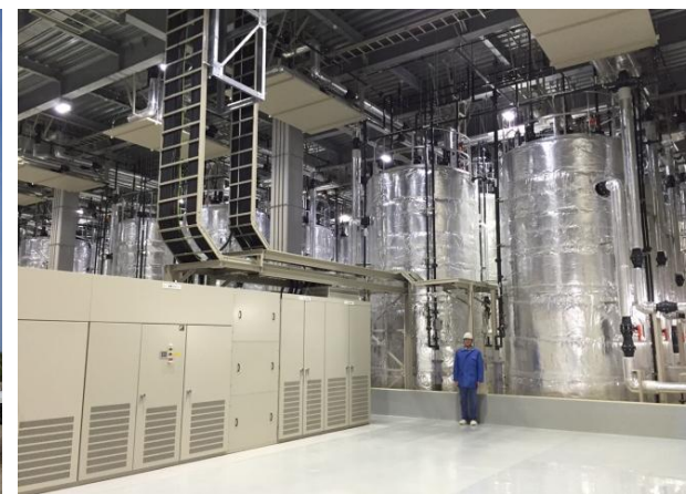
<建屋内の電解液タンク>
