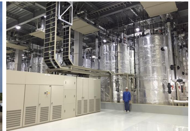
<建屋内の電解液タンク>
