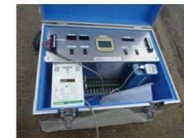
発電した電気を充電するシステム
